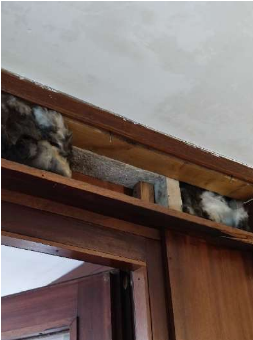
Abbildung 15: Sturzbereich Loggiaverbau, RfM Architektur
