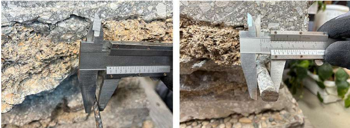
Abbildung 88: Stahlstäbe gefunden bei Fassadenplatten Marktgasse, TU Wien
